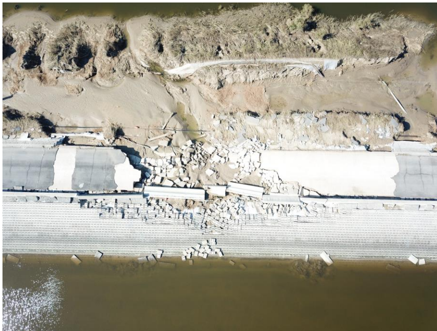
图 2-5 山东省东营市广饶县海堤受损
